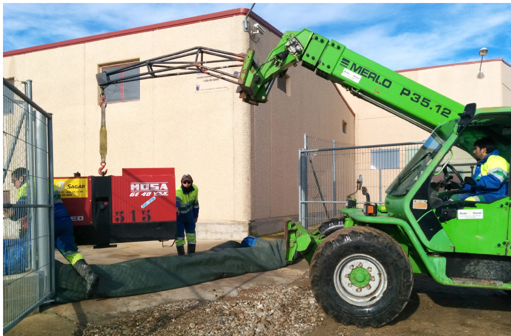
En la imagen, momento en que, siguiendo el plan de contingencia, se introducen los equipos auxiliares en la estación de tratamiento de agua potable (ETAP) de Calahorra (La Rioja).
